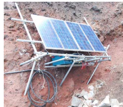
録画機、バッテリーと太陽電池
