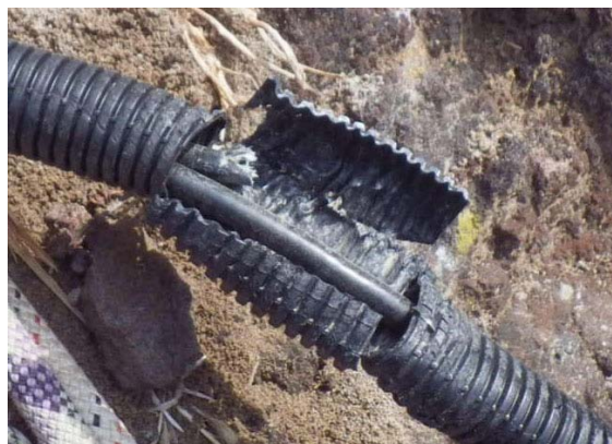
断線したケーブル(上)
