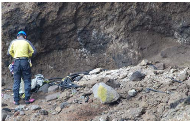
土砂崩れのため埋まった線
